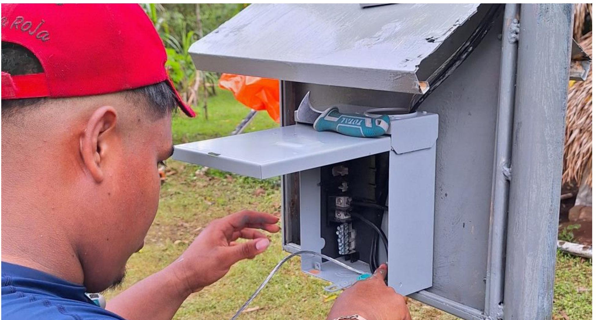
Sistema eléctrico del invernadero.
