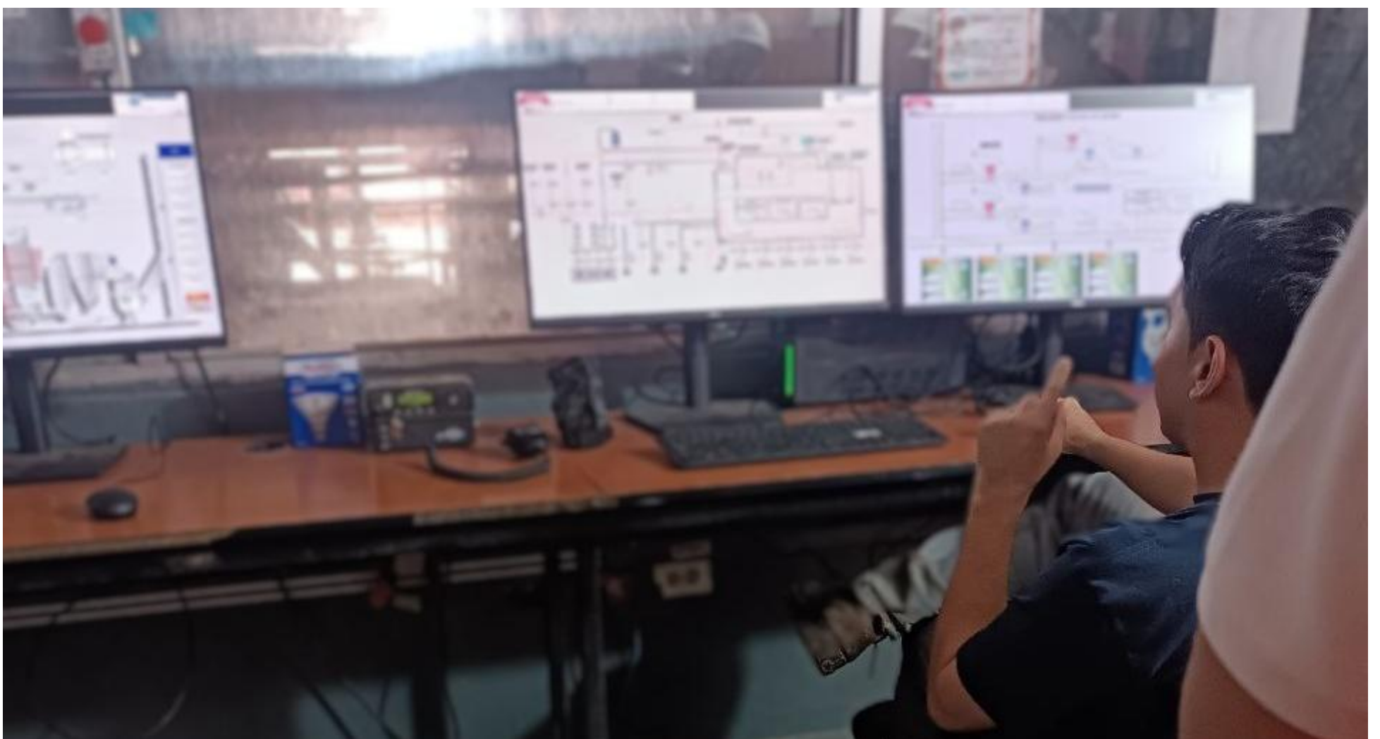
Centro de Control.
